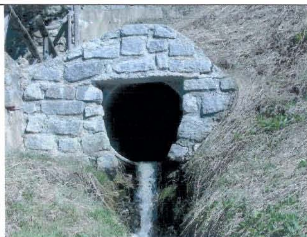
Foto 230 Sblocco tratto tombato della S.S. 301 (attraversamento basso).
