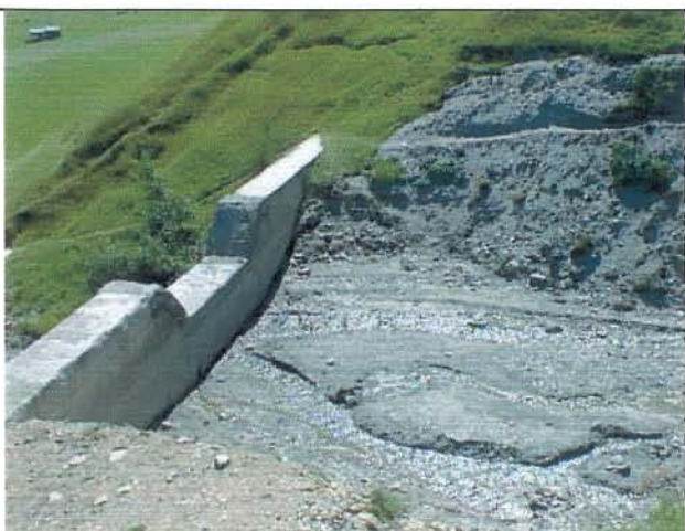
Foto 2 Prima briglia del sistema di tre briglie al termine del tratto boschivo (vista da monte)
