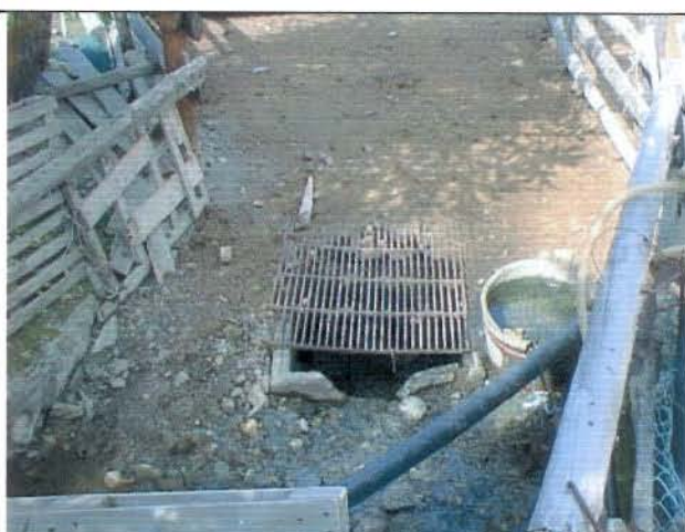
Foto 7 Imbocco del tratto tombato (φ 80) con griglia
