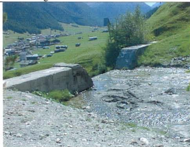
Foto 5 Seconda briglia del sistema di tre briglie al termine del tratto boschivo (vista da monte)
