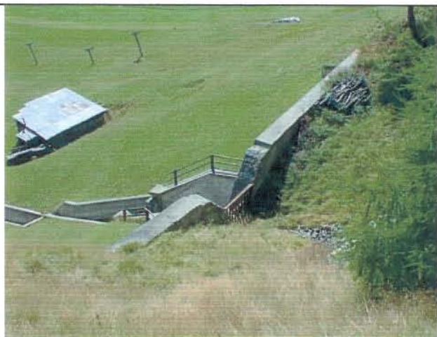
Foto 23 Ultima briglia prima del tratto canalizzato con grata (briglia selettiva)
