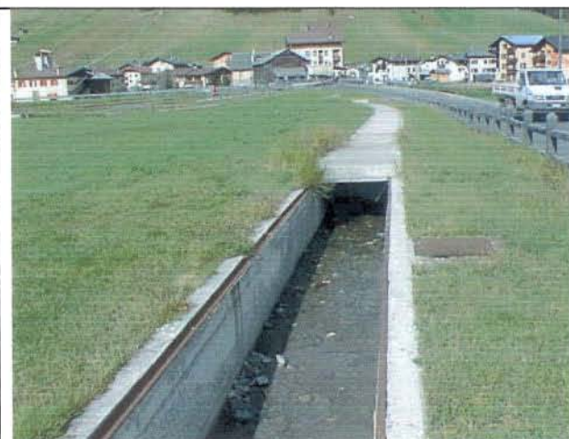
Foto 27 Tratto canalizzato lungo via Marangona: il cambio di pendenza causa un zona di deposito
