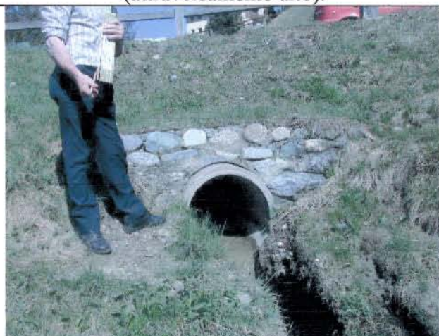
Foto 227 Sblocco tratto tombato pista ciclabile alta.
