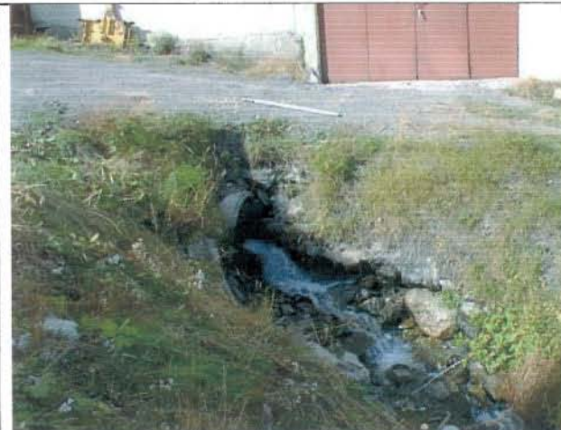
Foto 41 Sbocco del tombotto della SS. 301
