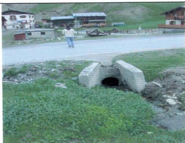
Foto 52 Tombotto di attraversamento di via Plan (diametro \phi 60) (vista da monte)
